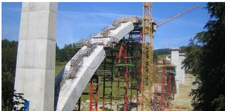
Je komplexer das Projekt, desto störanfälliger ist die Baustelle. Oft geht es um einschneidende Verzögerungen, immer um viel Geld. Dieser Brückenschlag kam wegen statischer Probleme und Ausführungsschwierigkeiten für ein Jahr ins Stocken
